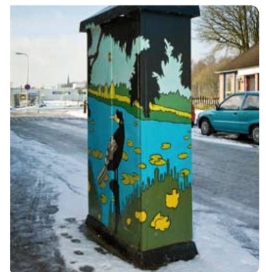
De fraaie elektriciteitskast aan de Lage Bothofstraat
